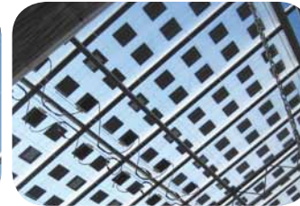
Pannelli al silicio policristallino semitrasparenti installati all'interno delle falde di una serra sperimentale presso il Cersaa di Albenga
