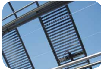
Pannelli CIS (Diseleniuro di rame e indio) semitrasparenti installati all'interno delle falde di una serra sperimentale presso il Cersaa di Albenga
