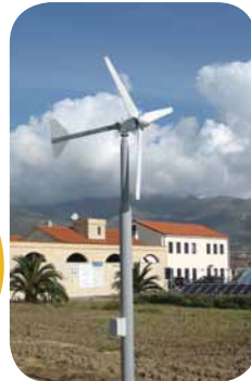
Generatore microeolico ad asse orizzontale installato presso il Cersaa di Albenga
